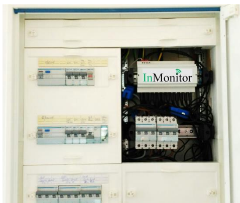
Fig. 4. InMonitor instalado num quadro elétrico.
